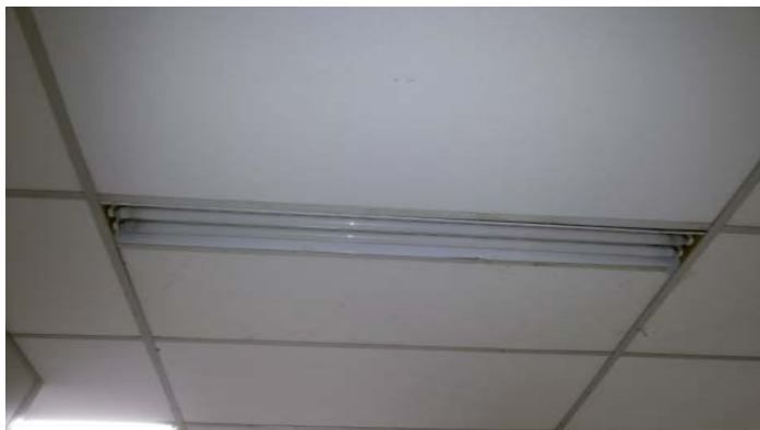
Figura 4 – Detalhe da luminária nas salas de aula
