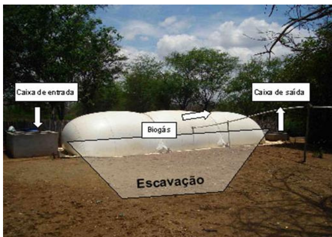
Figura 1 – Biodigestor modelo canadense
